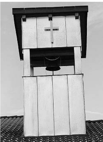
Viel Geld erfordert die Sanierung des Glockenturms am Schützenhaus. F.: br
